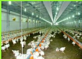
Отопление птичника водяными панелями лучистого отопления
